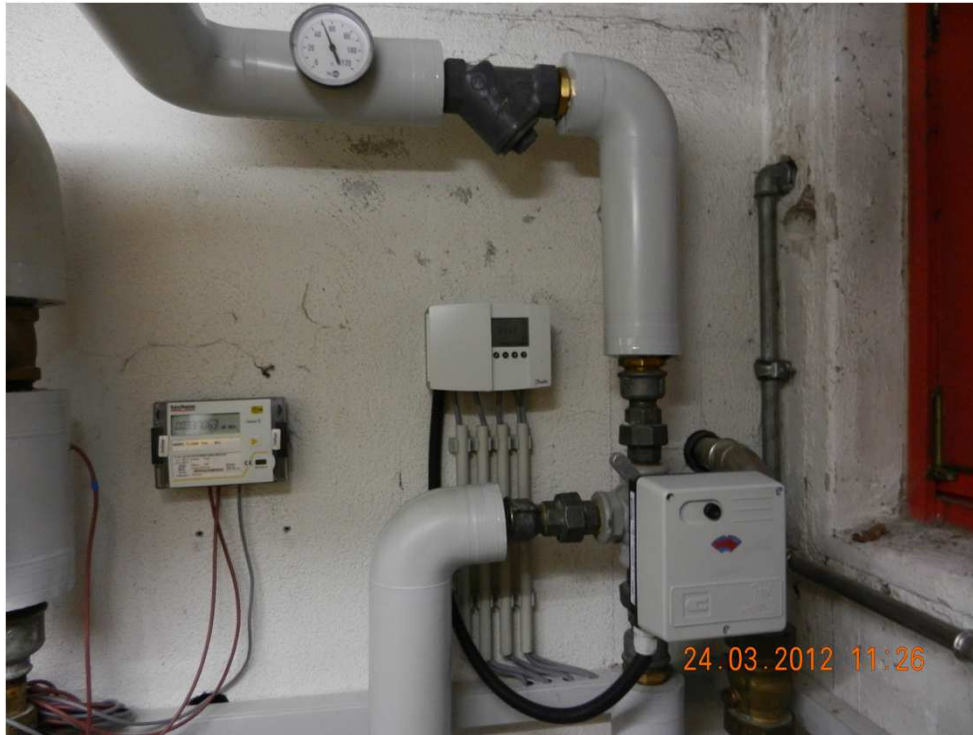
Abrechnungsmess-Stellen: Warmwasser und Heizung
