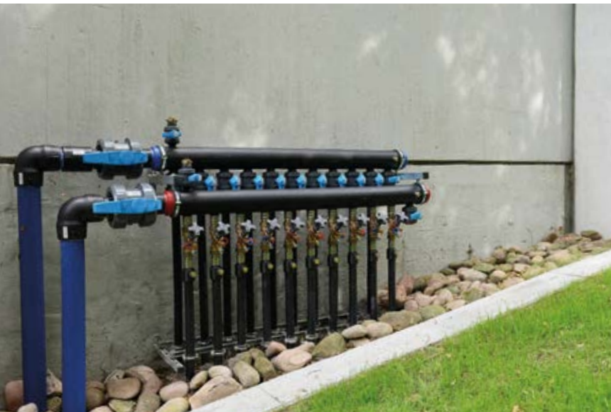
Übergabestation: Hier trifft die Wärmequelle auf die Wärmepumpe.
