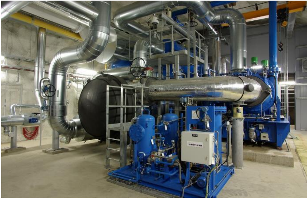
Wärmepumpe 20.000 kW bis 95°C (Stadt Wien)
