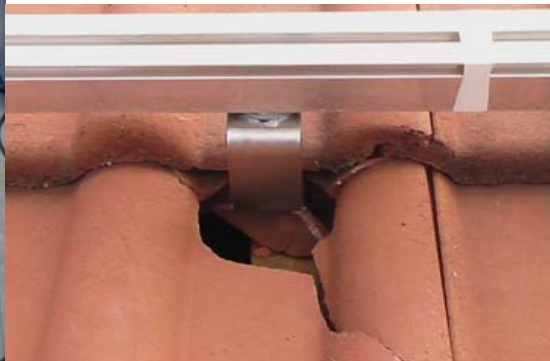
Bild 7: fehlerhafte Planung (Quelle Mannheimer)
