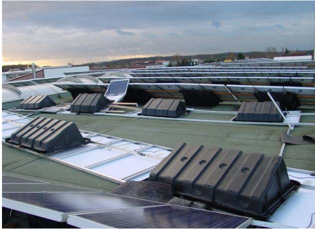
Bild 8: Sturmschaden durch Nichtbeachtung der Systemstatik (Quelle Mannheimer)
