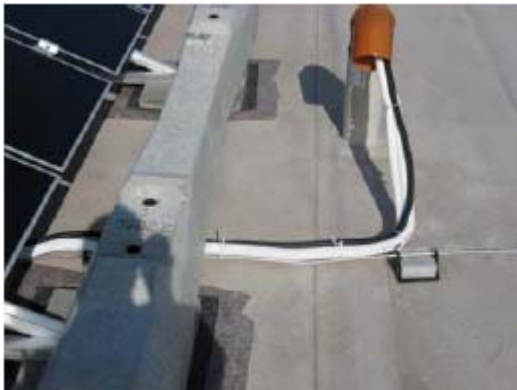
Bild 17: Abstand zwischen DC-Leitungen und Blitzschutzanlage nicht eingehalten (Trennungsabstand) (Quelle Markus Scholand)
