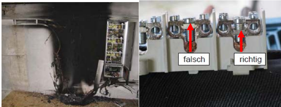
Bild 23: Brandschaden durch lose Klemmestelle an einem PV-Verteiler, aufgrund eines falsch eingelegten Gewindeplättchens, siehe rechts (Quelle Markus Scholand)
