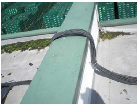
Bild 3: nicht erlaubte Verlegung von Leitungen über eine Brandwand (Quelle VGH)
