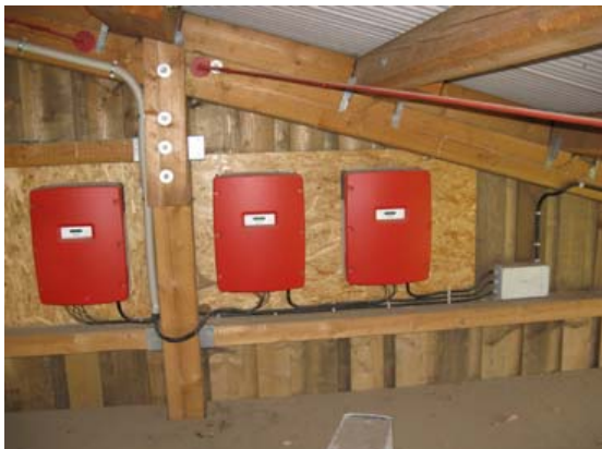
Bild 9: Montage von Wechselrichtern auf brennbaren Untergründen ist nur mit Zustimmung des Herstellers erlaubt. (Quelle Markus Scholand)
