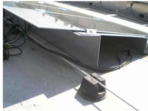
Bild 18: Abstand zwischen DC-Leitungen und Blitzschutzanlage nicht eingehalten (Trennungsabstand) (Quelle VGH)
