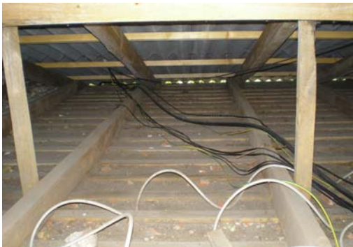
Bild 12: nicht fachgerechte Leitungsverlegung (Quelle VGH)
