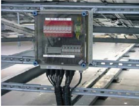
Bild 19: Generatoranschlusskasten mit Überspannungsschutzeinrichtungen (Quelle Hensel)
