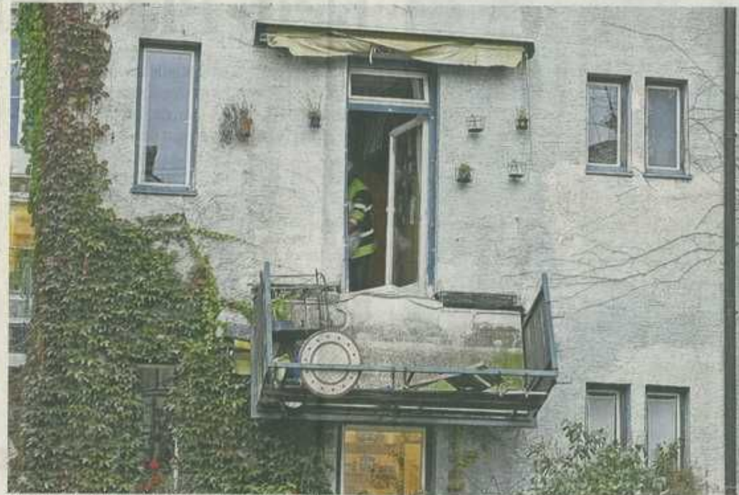
Der abgeknickte Balkon – die Stahlbetonkonstruktion ist plötzlich weggebrochen.
