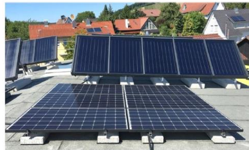
PV-Anlage für Eigenverbrauch Haushaltsstrom: 12 kWp (pro Wohnung 2 kW) Im Hintergrund: Kollektoren aufgeständert
