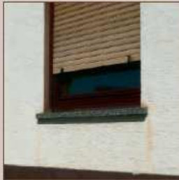
Schmutzabläufer aufgrund unterlassener Reinigung der Fensterbank.
