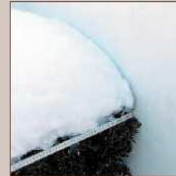
Schnee auf einer Hecke direkt am Fassadenputz anliegend.
