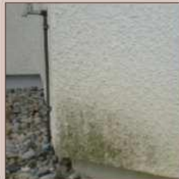
Verschmutzter, veralgter Sockelbereich
