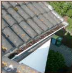
Unterlassene Reinigung kann zum Überlaufen der Dachrinne und somit zu Schmutzabläufern an der Fassade führen.
