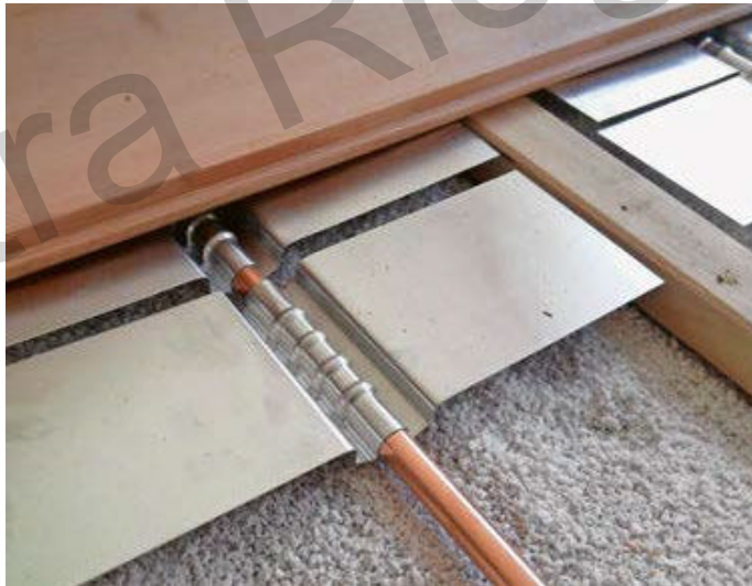
Kupferrohre und Aluminium- Wärmeleitbleche
