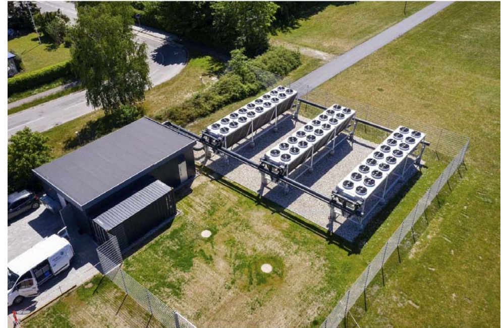
Quelle: PlanEnergi, 1 MW Luft-Wärmepumpe in Dänemark
