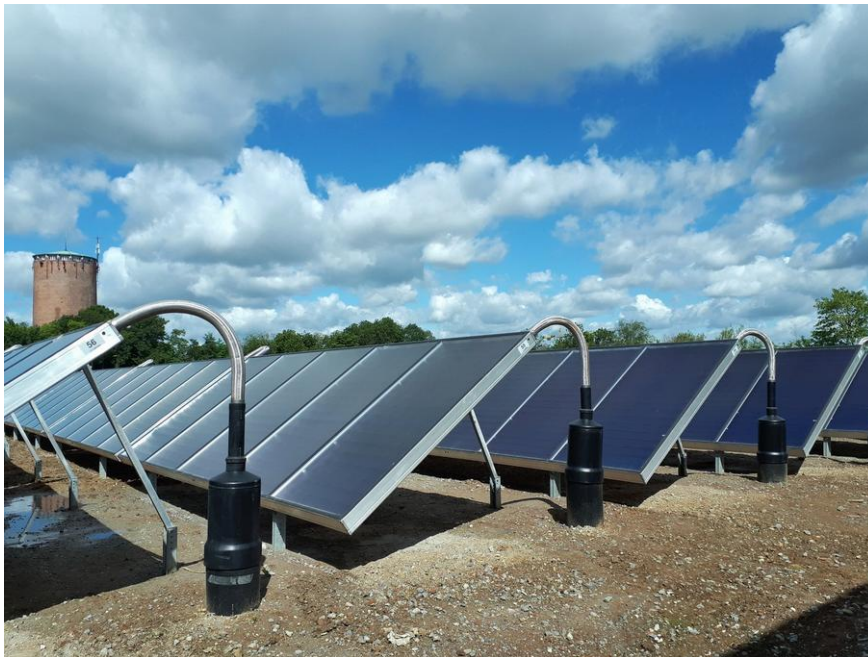
Foto: Solarthermie-Freiflächenanlage in Ludwigsburg
