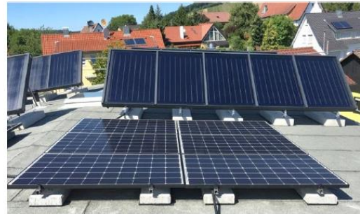
PV-Anlage für Eigenverbrauch Haushaltsstrom: 12 kWp (pro Wohnung 2 kW) Im Hintergrund: Kollektoren aufgeständert
