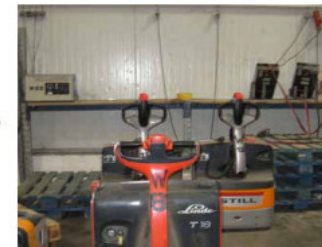
Schlechtes Beispiel: Brennbare Paletten in unmittelbarer Nähe
