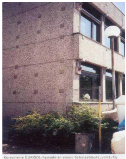
Korrodierte DURISOL-Fassade an einem Schulgebäude, vorläufig
