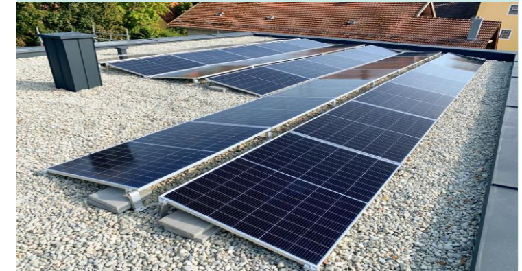
PV auf Kiesdach
