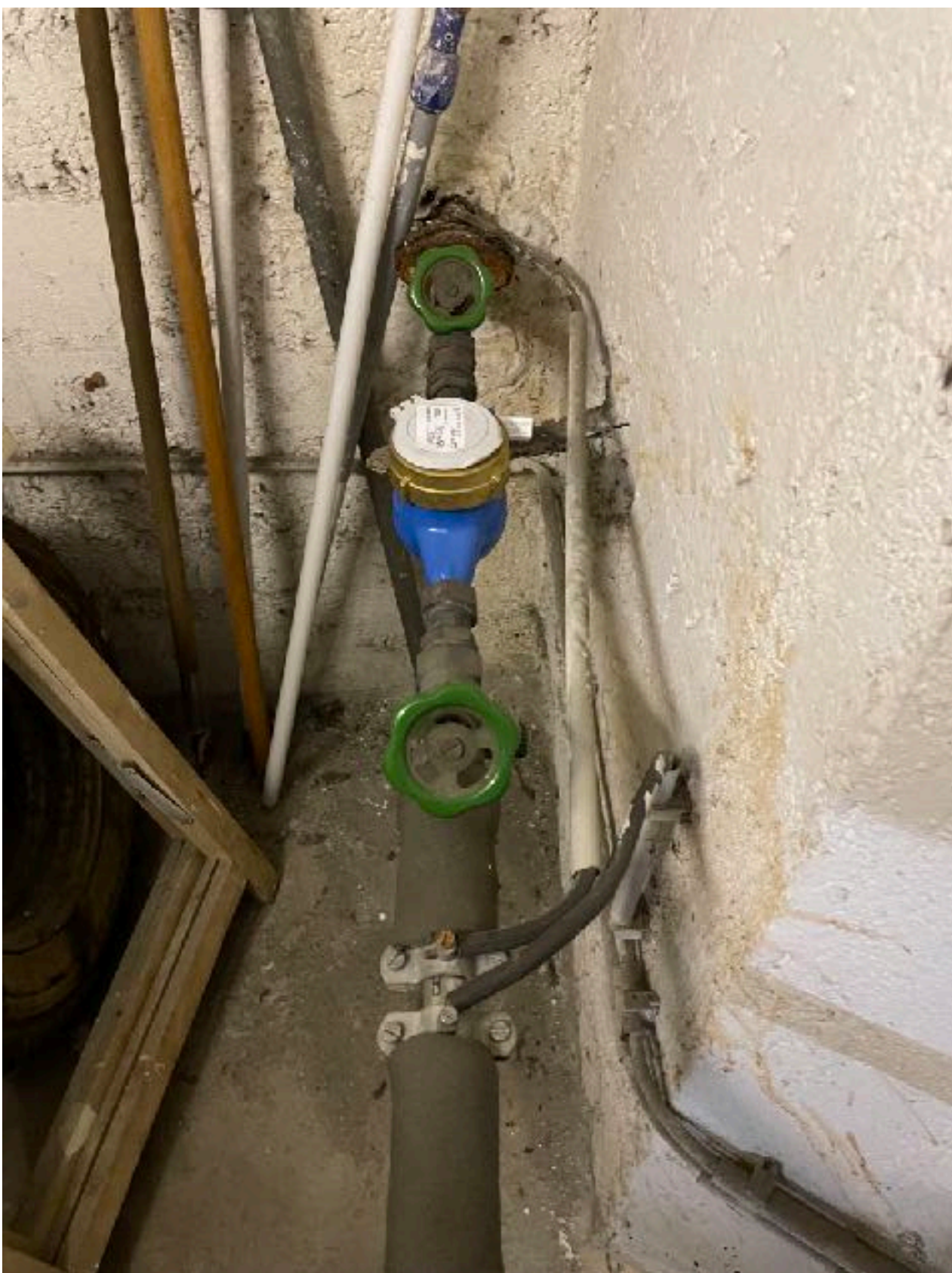
Alte Erdung über Wasserrohr
