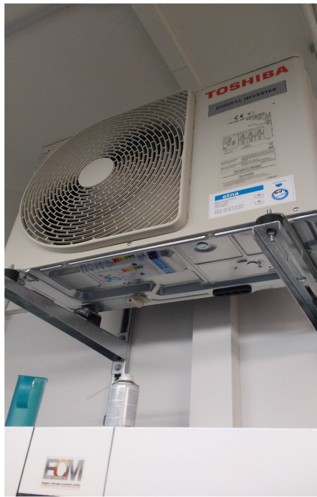
im Raum AirCon Outdoor Unit
