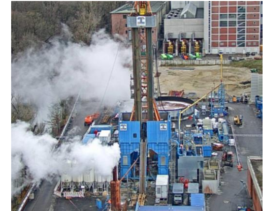
Geothermie Schäftlarnstraße, Th2, Testphase
