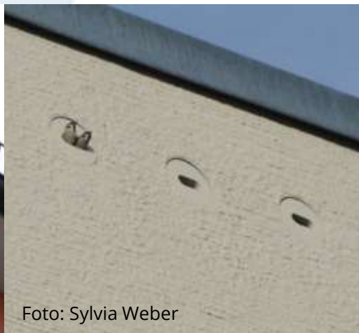
Niststeine in Fassade integriert
