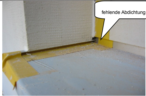
Bild 4: Fehlerhaftes Eck-Detail! Der Anschluss WDVS/Fensterrahmen/Fensterbrett ist nicht schlagregendicht ausgeführt, Feuchterisiko!
