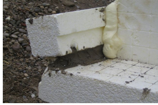
Bild 2: Polystyrol WDVS – keine fachgerechte Verarbeitung (vom Bauleiter nicht beanstandet) überbreite und unsachgemäß geschlossene Fuge
