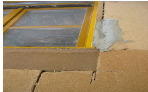
Bild 6: Holzfaser-WDVS schlampig verarbeitet und lückenhaft verlegt, kein fachgerechter Plattenverbund. Wärmebrücken!
