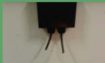
PV-Module mit fehlenden Steckern
