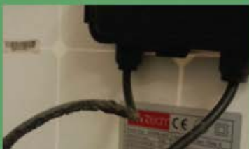
PV-Module mit defekten Solarkabeln
