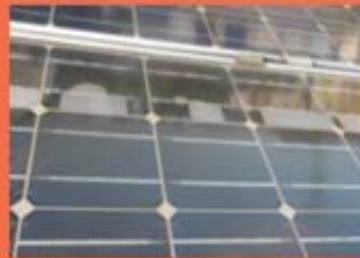
PV-Module mit Delamination
