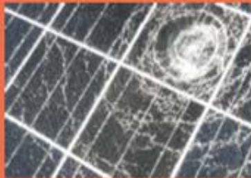
PV-Module mit Glasbruch
