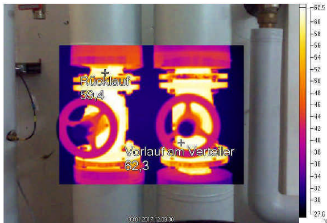
Bild 6 Rück- und Vorlauftemperatur direkt am Verteiler, hin zum Pufferspeicher
