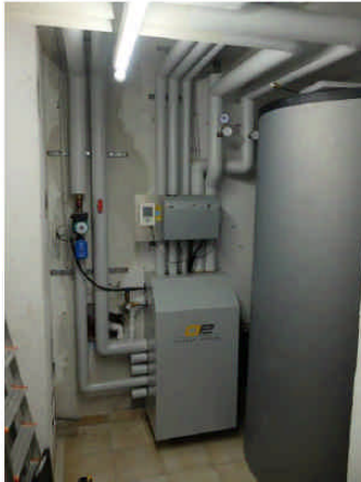
Bild 11 Pufferspeicher mit Frischwassermodul im Haus Nr. 13
