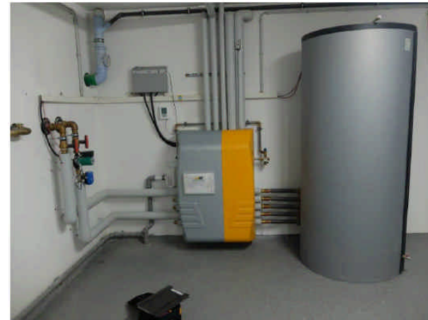
Bild 9 Pufferspeicher mit Frischwassermodul im Haus Nr. 13d
