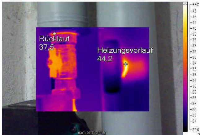
Bild 12 Haus Nr. 13, Zum Zeitpunkt der Aufnahme erfolgte keine Nachladung des Pufferspeichers. Haus Nr. 13 wird mittels Heizkörper mit Raumwärme versorgt.
