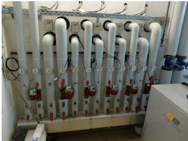
Bild 5 Verteilung der diversen Häuser im Heizraum von Hausnummer 11
