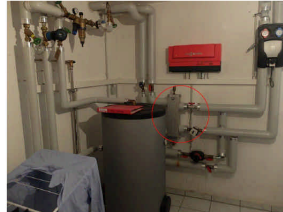
Bild 15 Heiztechnik mit Brauchwarmwasserspeicher und hydraulische Weiche (Roter Kreis) im Haus 13c.
