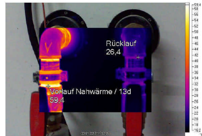
Bild 10 Aufnahme in Infrarot, kurz nach dem Öffnen des Ladeventils im Haus Nr. 13d
