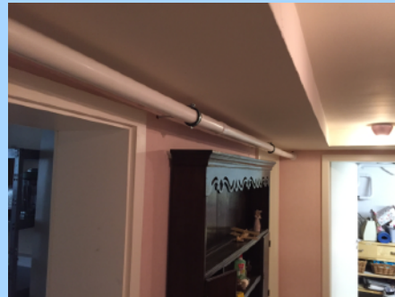
2017 Neue Rohrleitung zu Absaugpunkt 2
