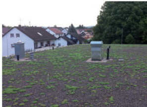
Auf dem Gründach sorgt der EC-Dachventilator DVSAR-A40 für eine bedarfsgerechte Abluhr der verbrauchten Luft.
