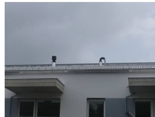
Abluft über Dach
