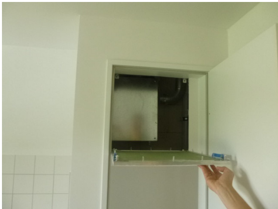
Dezentraler Abluftventilator in der Wohn - Einheit
