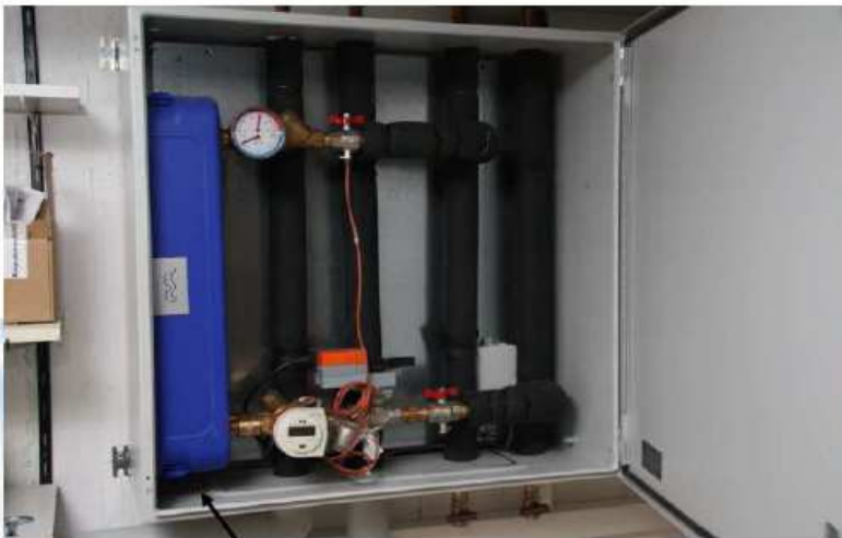
Wärmetauscher 50 kW th
