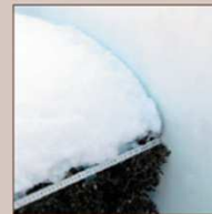
Schnee auf einer Hecke direkt am Fassadengutz anliegend.
