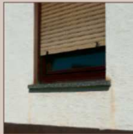
Schmutzabläufer aufgrund unterlassener Reinigung der Fensterbank.
