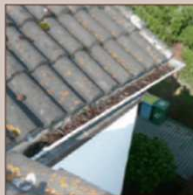
Unterlassene Reinigung kann zum Überlaufen der Dachrinne und somit zu Schmutzabläufen an der Fassade führen.
