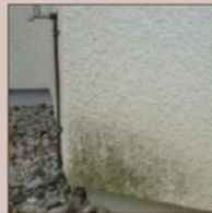
Verschmutzter, veralgter Sockelbereich
