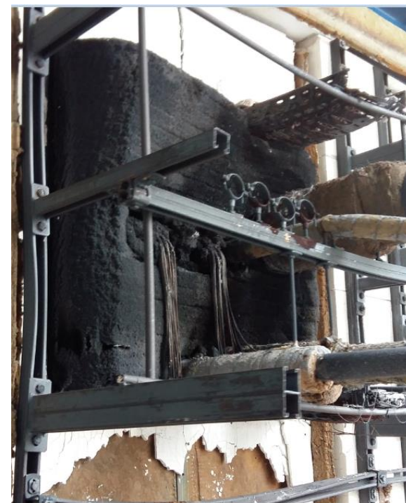
Brandseite nach dem Test ⇒ F90
