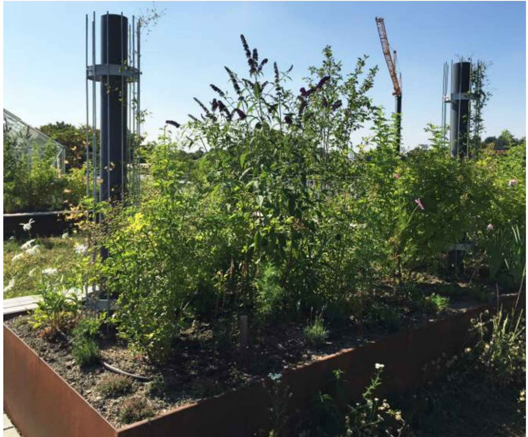
Gründach mit Zuluft und Abluft über Dach, Dachgarten Wagnis 4, München
