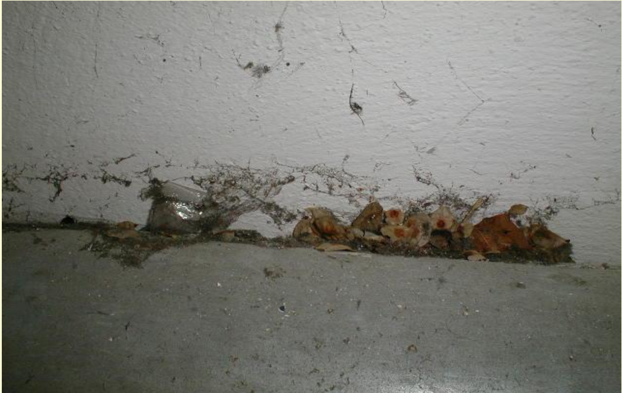
Edmund Bromm Sachverständiger für Feuchte- und Schwammschäden www.denkmal-pflege.de
