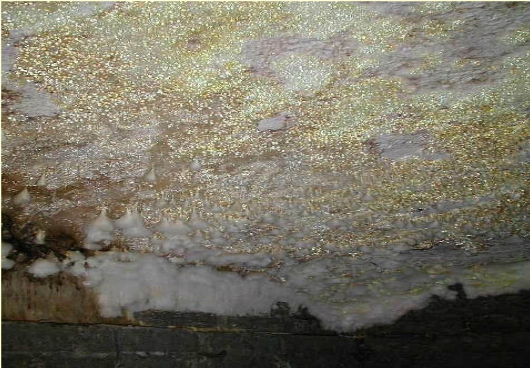
Edmund Bromm Sachverständiger für Feuchte- und Schwammschäden www.denkmal-pflege.de
