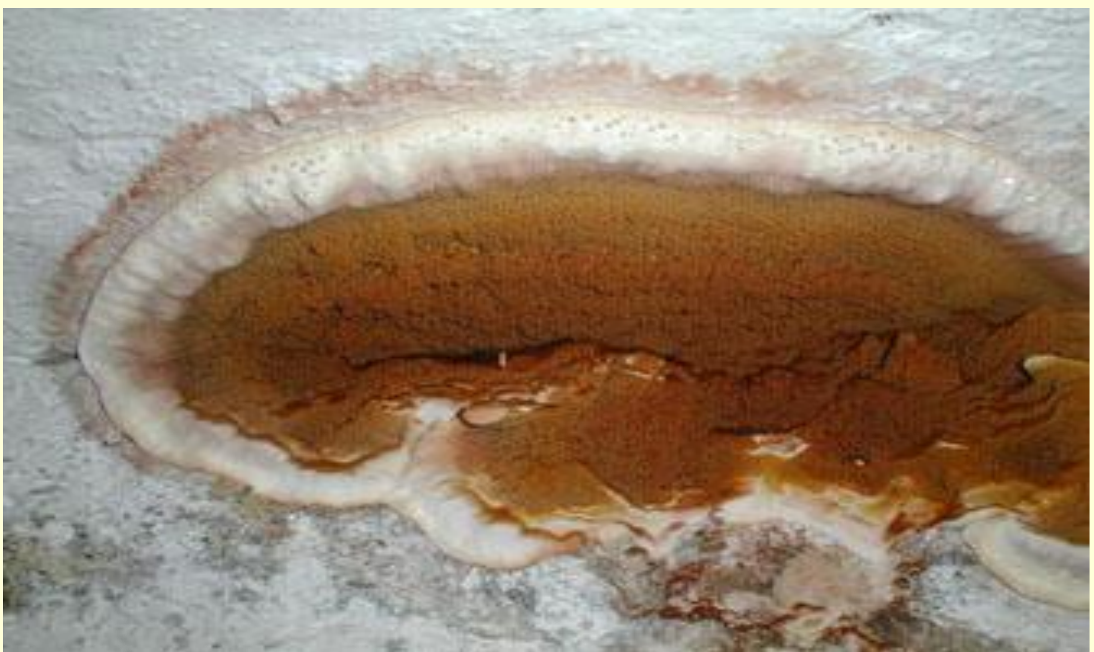
Edmund Bromm Sachverständiger für Feuchte- und Schwammschäden www.denkmal-pflege.de
