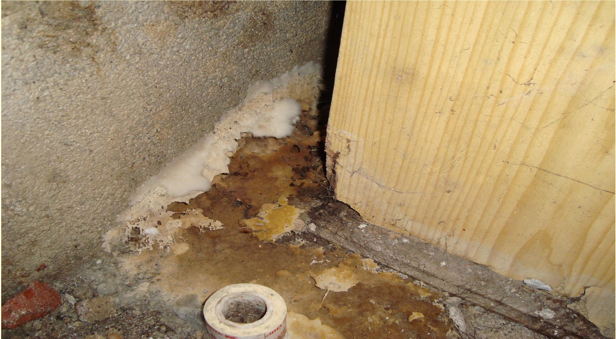
Edmund Bromm Sachverständiger für Feuchte- und Schwammschäden www.denkmal-pflege.de
