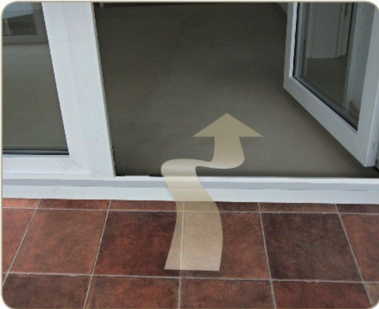
Vorher Türschwellen stellen ein Sturzrisiko dar
