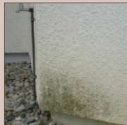
Verschmutzter, veralgter Sockelbereich
