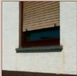
Schmutzläufer aufgrund unterlassener Reinigung der Fensterbank.
