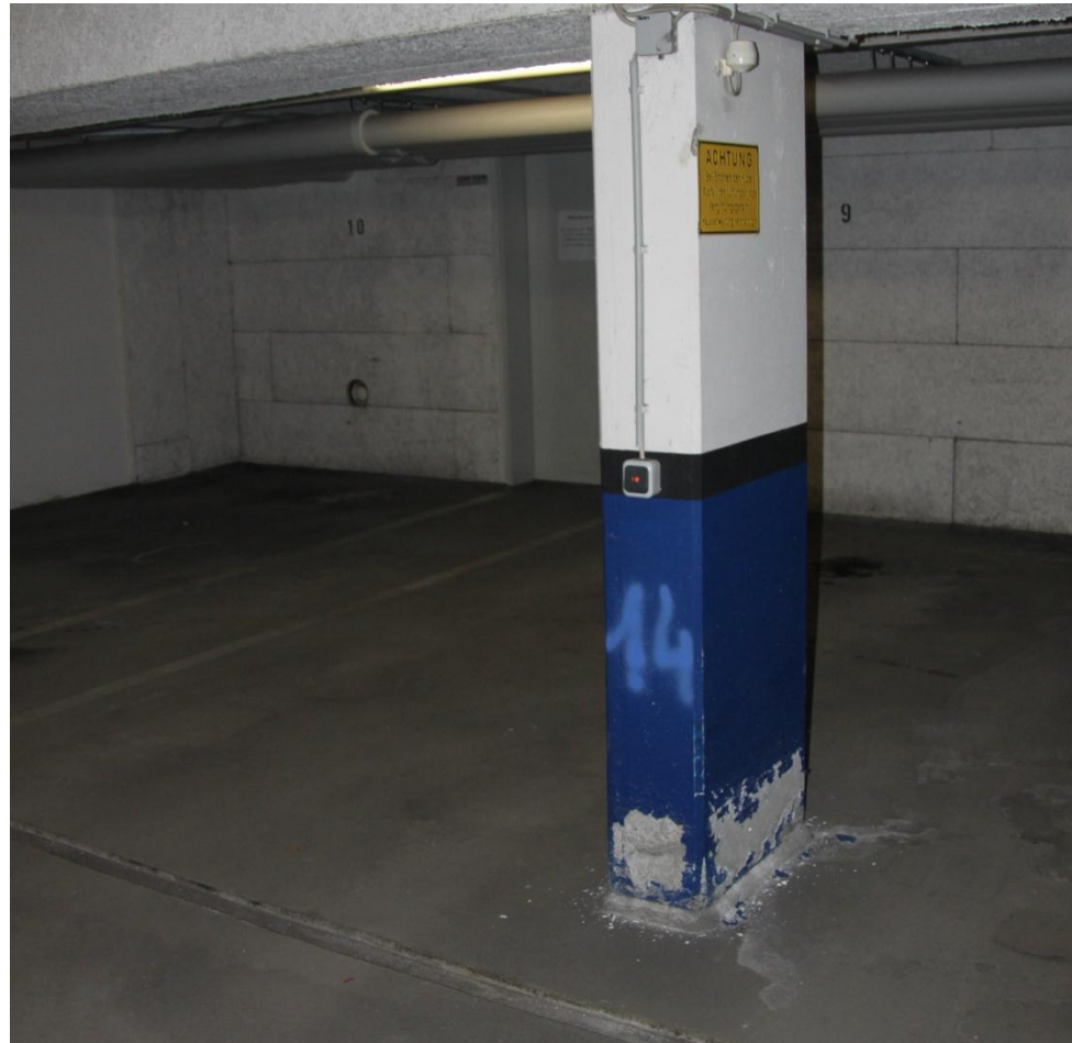
Chlorideintrag an Stützen
