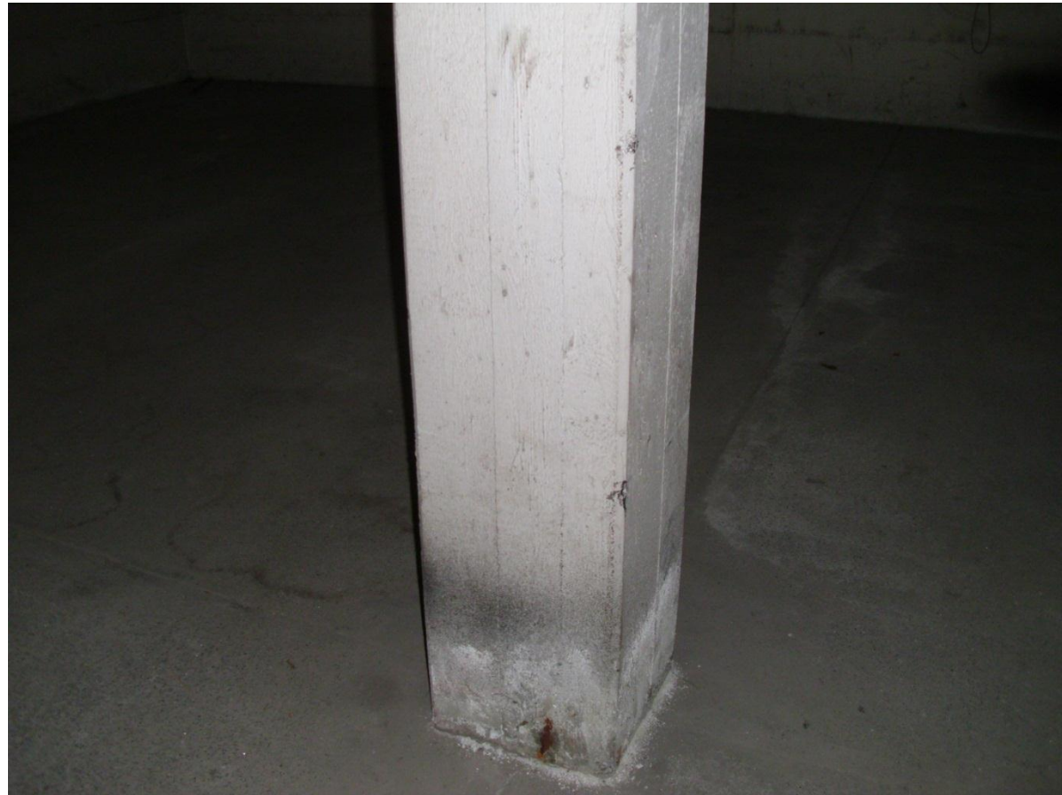
Chlorideintrag an Stützen
