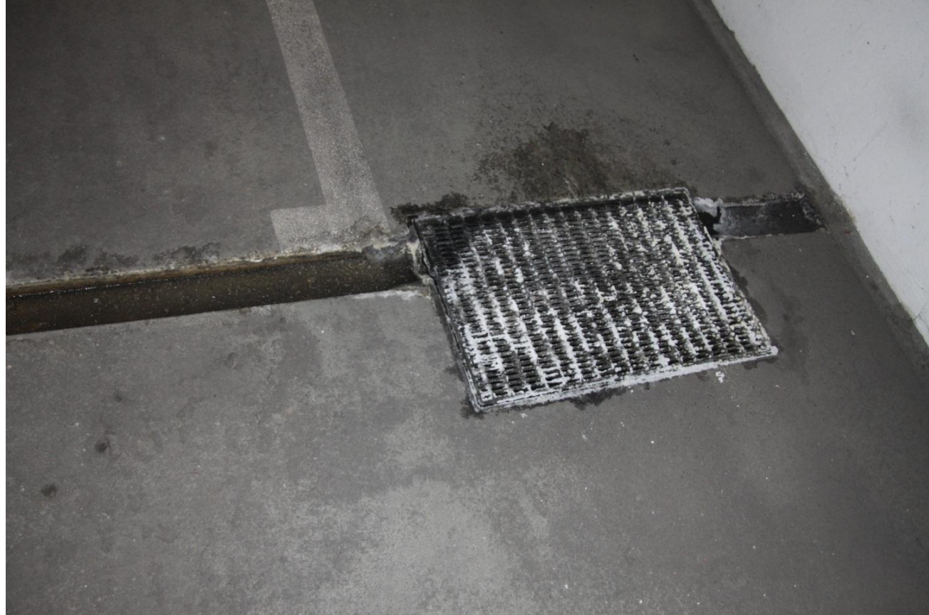
Schäden durch Chlorideintrag
