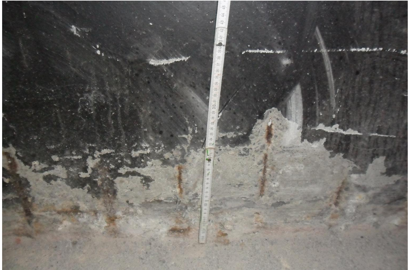
Chlorideintrag am Wandsockel
