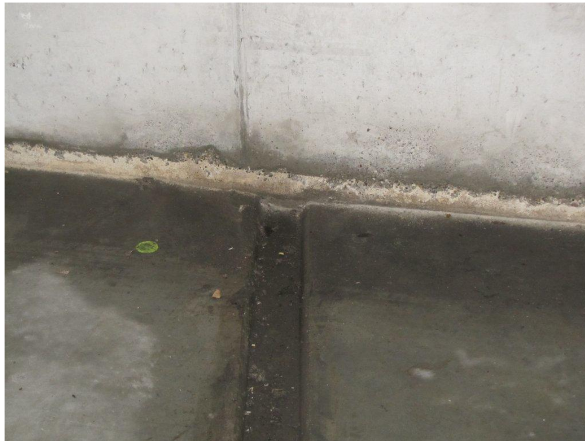
Chlorideintrag am Wandsockel
