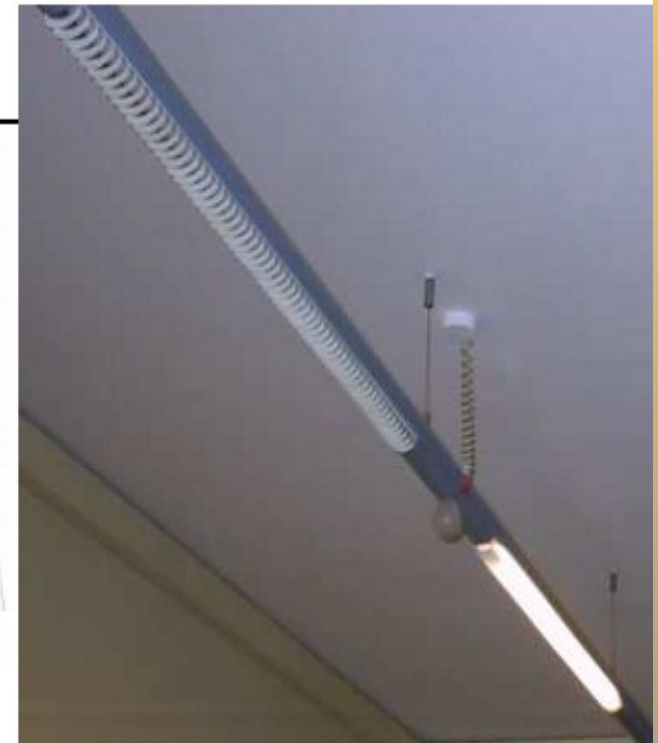
Lichtrohrsystem auf einem Flur
