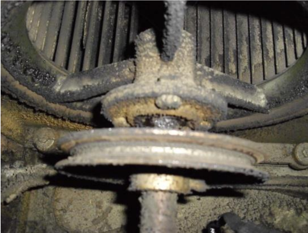
Abluftmotor einer Gaststätte
