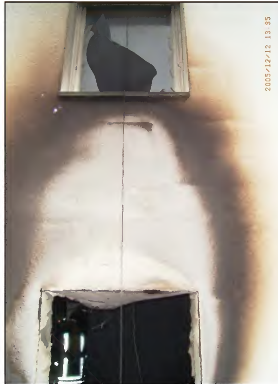
nach dem Versuch, Putz im Sturz offen, Brandüberschlag durch Fenster
