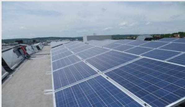
IKEA Fachmarktzentrum Ulm – 500 kWp
