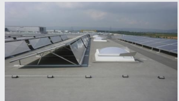
IKEA Frankfurt - 500 kWp
