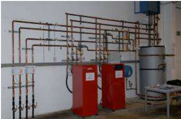
AMASOND F&E Testanlage
