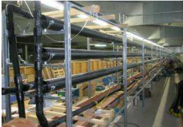
AMASOND F&E Versuchsanlage
