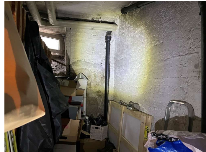
Vorhandene, defekte Rohrleitungen
