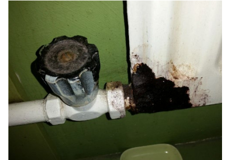
Alte Ventile, Korrosion an Heizflächen
