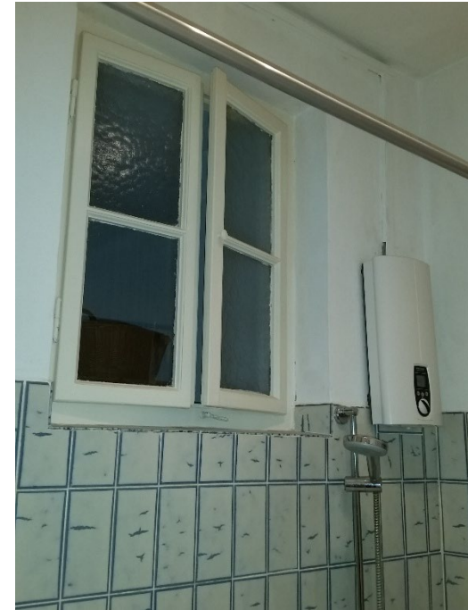
Durchlauferhitzer ca. 21 KW
