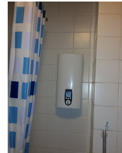
Durchlauferhitzer ca. 21 KW
