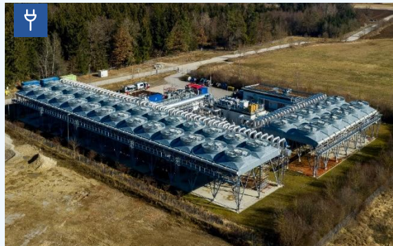
Geothermieranlage Dürrnhaar In Betrieb seit 2012
