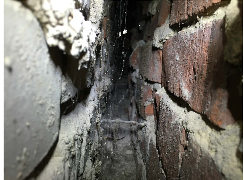
Mauerwerksmörtel löst sich aus den Lagen
