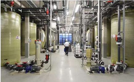
Großspeicher in Pfinztal (10 MWh) Bild: ICT / Uli Deck
