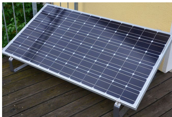
PV-Modul auf dem Balkon
