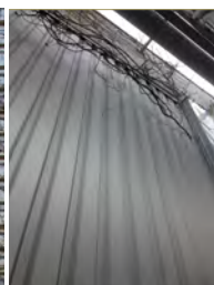
Einwachsen der Begrünung in offene Bauteilfugen. Ungenügende Pflege/falsche Pflanzenentscheidung. Abb.: Stefan Brandhorst
