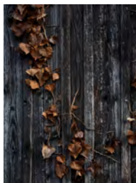
Pilzbefall an Holzoberfläche unter beseitigtem Hedera Helix-Bewuchs, www.fotocommunity.de, Holzwerk mit Efeu, © miville
