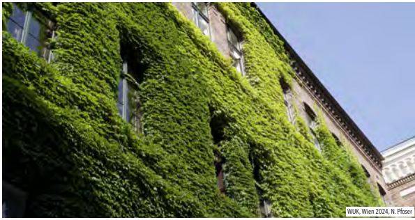
Schutz bestehender Begrünungen
