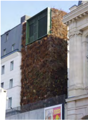
Ausfall von Pflanzen durch funktionsgestörte Bewässerung/ ungenügende Pflanzenauswahl nach Exposition/Klima.
