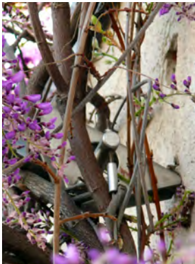
Ungünstige Pflanzenwahl/ungeeignete Materialwahl, Starkclimber (Wisteria sinensis) an unterdimensionierter Wuchskonstruktion, Zerstörung von Putz und Dämmung. Abb.: Sven Taraba
