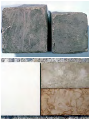
Ätzwirkung der Haftwurzeln von Hedera Helix Althaus, C. (1987): Fassadenbegrünung. Ein Beitrag zu Risiken, Schäden und präventiver Schadensverhütung. Bielefeld, S. 57 Verfärbung durch verrottende Blätter, © Prof. C. Althaus
