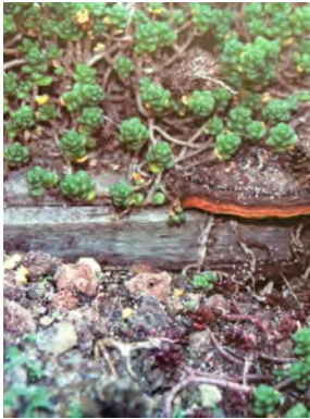
Ungeeignete Schubsicherung einer Schrägdachbegrünung. Holzlattengerüst mit Pilzbefall. (© FL Schadensfallsammlung GalaBau)
