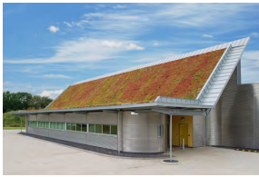
oben: ungeeignetes Substrat, Staudepflanzung statt Vegetationsmatten. ( https://www.optigrun.de/fileadmin/content/Prospekte/4_Sonstige_Broschueren/Optigrun-Schadensfallsammlung_Dachbegrueunung_Sonderheft_2013.pdf ) unten: Lösung des Problems durch geeignetes Substrat und Verwendung von Vegetationsmatten. BfI England - das Opti-Grün-Dach des Jahres 2012 (Optigrun)
