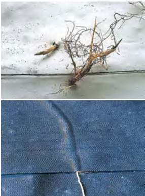
Kunststoffdichtungsbahn: Durchwurzelung neben der Naht, Kautschukdichtungsbahn: Durchwurzelung im geklebten Nahtbereich. (Ernst, W. (2002): Dachabdichtung, Dachbegrünung, Fehler. Stuttgart, S. 22)
