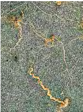
Polymerblumenbahn: Durchwurzelung in der Fläche, (Ernst, W. (2002): Dachabdichtung, Dachbegrünung, Fehler. Stuttgart, S. 22)
