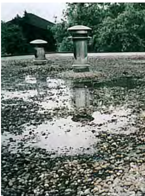
Fehlendes Gefälle, Wasseranbau. (Ernst, W. (2002): Dachabdichtung, Dachbegrünung, Fehler. Stuttgart, S. 23) Folge: nicht mit eingeplante Lasten, lückenhafter Bewuchs, Ausfall von Pflanzen, Entwicklung von Moos- und/oder Gras-Vegetationen.
