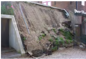
Schubschwellen aus Holz und Entwässerungsprobleme. Abrutschen einer nicht an das Gefälle angepassten Dachbegrünung. Ungeeignete Schubsicherungen und nicht angewachsene Vegetationsmatten. ( https://www.optigrun.de/fileadmin/content/Prospekte/4_Sonstige_Broschueren/Optigrun-Schadensfallsammlung_Dachbegrueunung_Sonderheft_2013.pdf )
