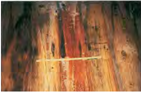
Schnell noch vor dem Winter... Dachabdichtung bereits durchfeuchter Bausubstanz, eingeschlossene Feuchtigkeit mit beginnender Fäulnis und Pilzfall. (Ernst, W. (2002): Dachabdichtung, Dachbegrünung, Fehler. Stuttgart, S. 128)
