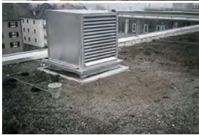
Bearbeitung der Dachbegrünung durch Wärmeabstrahlung der Südfassade. Vegetationsausfall im Ausläuferbereich des Dachlufers. (Ernst, W. (2002): Dachabdichtung, Dachbegrünung, Fehler. Stuttgart, S. 90)
