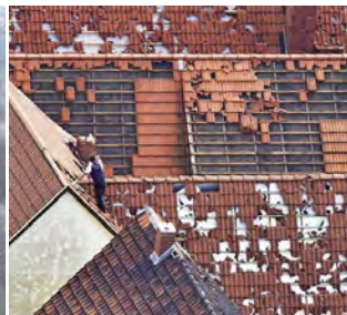
Sturm- und Hagelschäden
