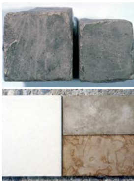
Ätzwirkung der Haftwurzeln von Hedera helix Althaus, C. (1987): Fassadenbegrünung. Ein Leitratz zu Risiken, Schäden und präventiver Schadensverhütung. Berlin, S. 57 Verfärbung durch verrottende Blätter, © Prof. C. Althaus
