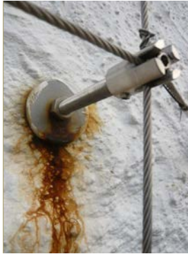
Korrosion, rostende Bauteile oder angebohrte Eisenbewehrung. Abb.: Sven Taraba
