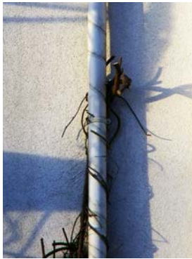
Falsche Pflanzenwahl, Starkschlinger an Regen-Fallrohr. Hieronwuchs, beginnende Zerstörung.
