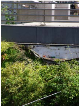
Unkontrollierter Wuchs durch fehlende Pflegemaßnahmen/ Unterdimensionierung der wuchstragenden Sekundärkonstruktion, Ablösung der Fassadenbegrünung, Feuchtschaden und Schimmelbildung
