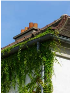
Nichtbeachtung der Wuchshöhe führt zum Hinterwachsen von Dachrinne und Dachdeckung. Erhöhter Pflegeaufwand erforderlich
