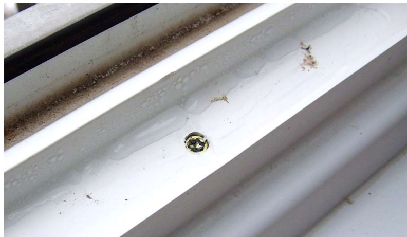
Tauwasser in der Verstärkungskammer und an der Befestigung
